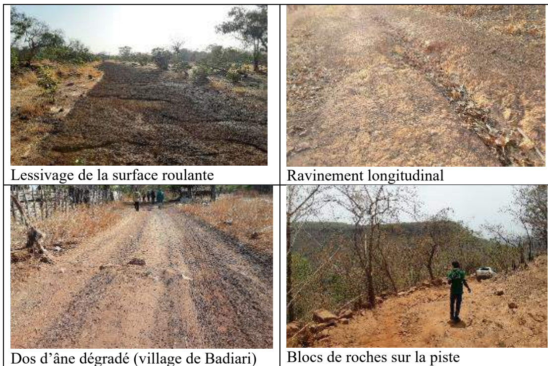
PHOTO 6: ANOMALIES IDENTIFIEES SUR LA PISTE SEGOU-FRONTIERE (SOURCE : MISSION DU 28 AVRIL AU 02 MAI 2023, HPR-ANKH)
