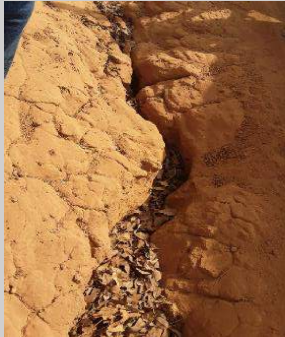
Ravinement poussée de la chaussée (X - 12.278476 ; Y 12.418810)
