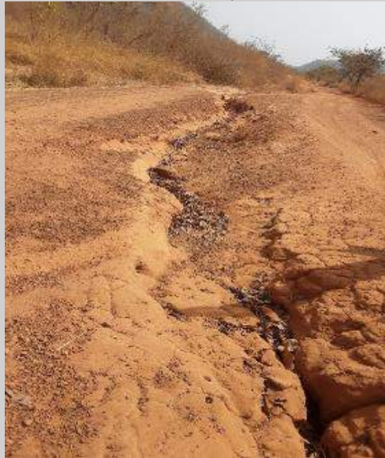
Ravinement de la chaussée (X -12.278497 ; Y 12.418807)
