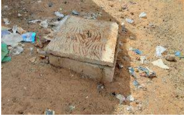
Regard ONAS à Mbeuleukhé
