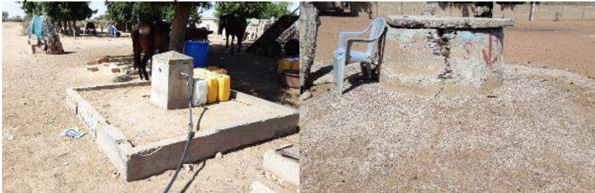
Borne fontaine (X : 462019,2 ; Y : 1709590) Puits fonctionnel (X : 462084 ; Y : 1709548)
