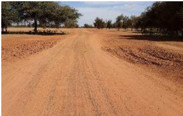
Zone de stagnation d'eau pluviale
